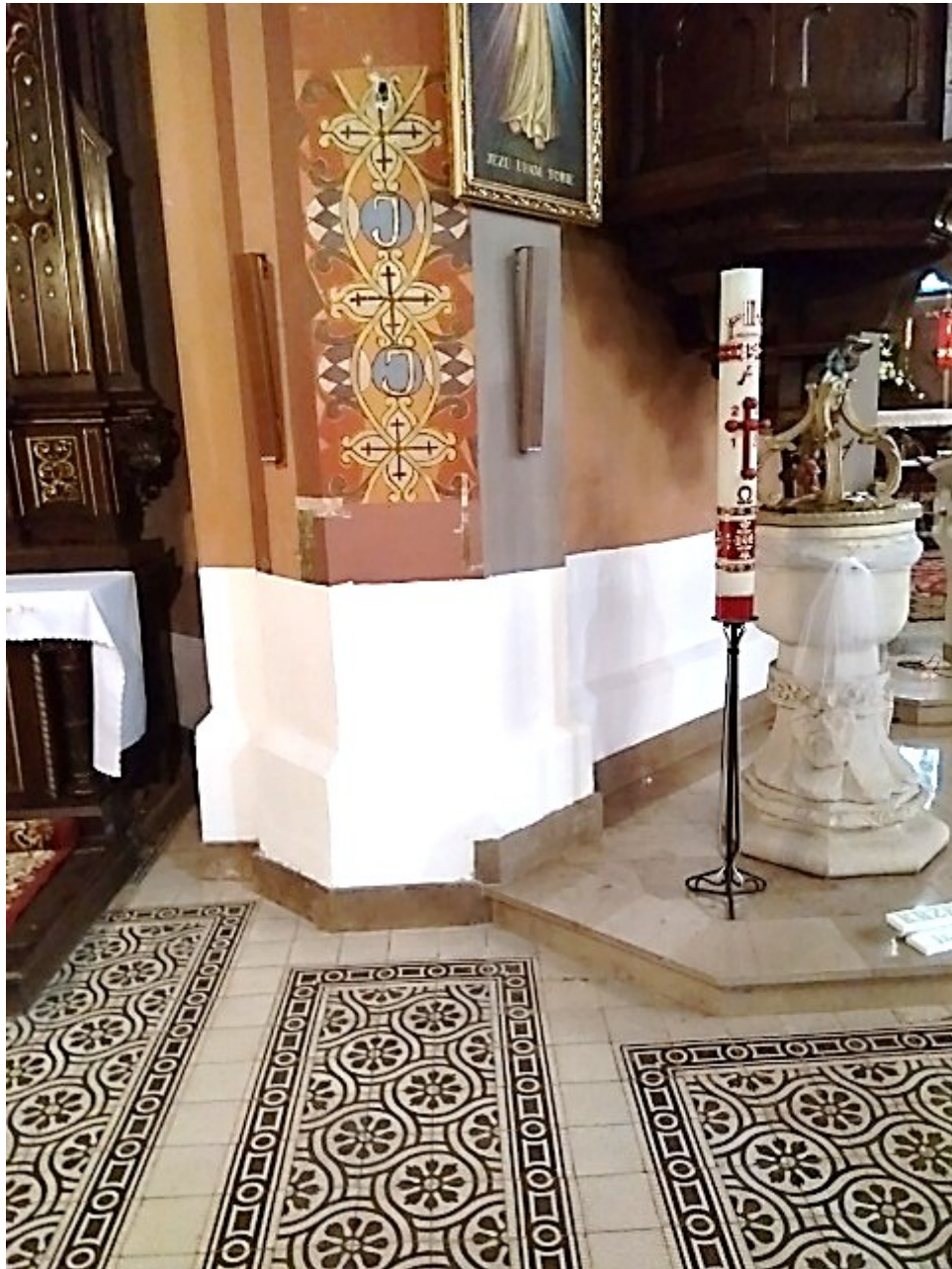
9. Wnętrze kościoła pw. św. Apostołów Piotra i Pawła w Porębie Radnej - fragment ściany nawy głównej, strona pn. z wymienionym pasem tynków po wykonanej izolacji poziomej
